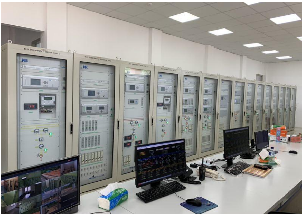
项目 240MW 升压站控制室
